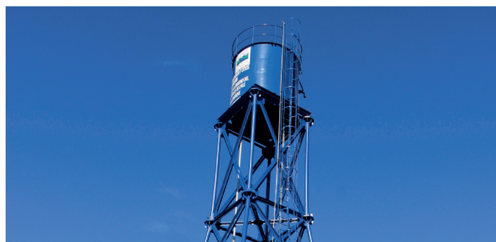
Infraestructura APR Rinconada
