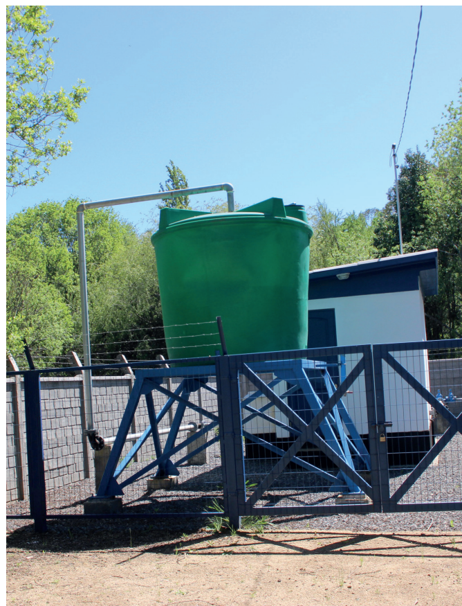
Infraestructura APR Los Lirios
